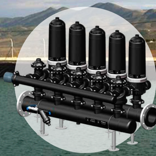
Batería de 5 Filtros Automáticos de 3"
